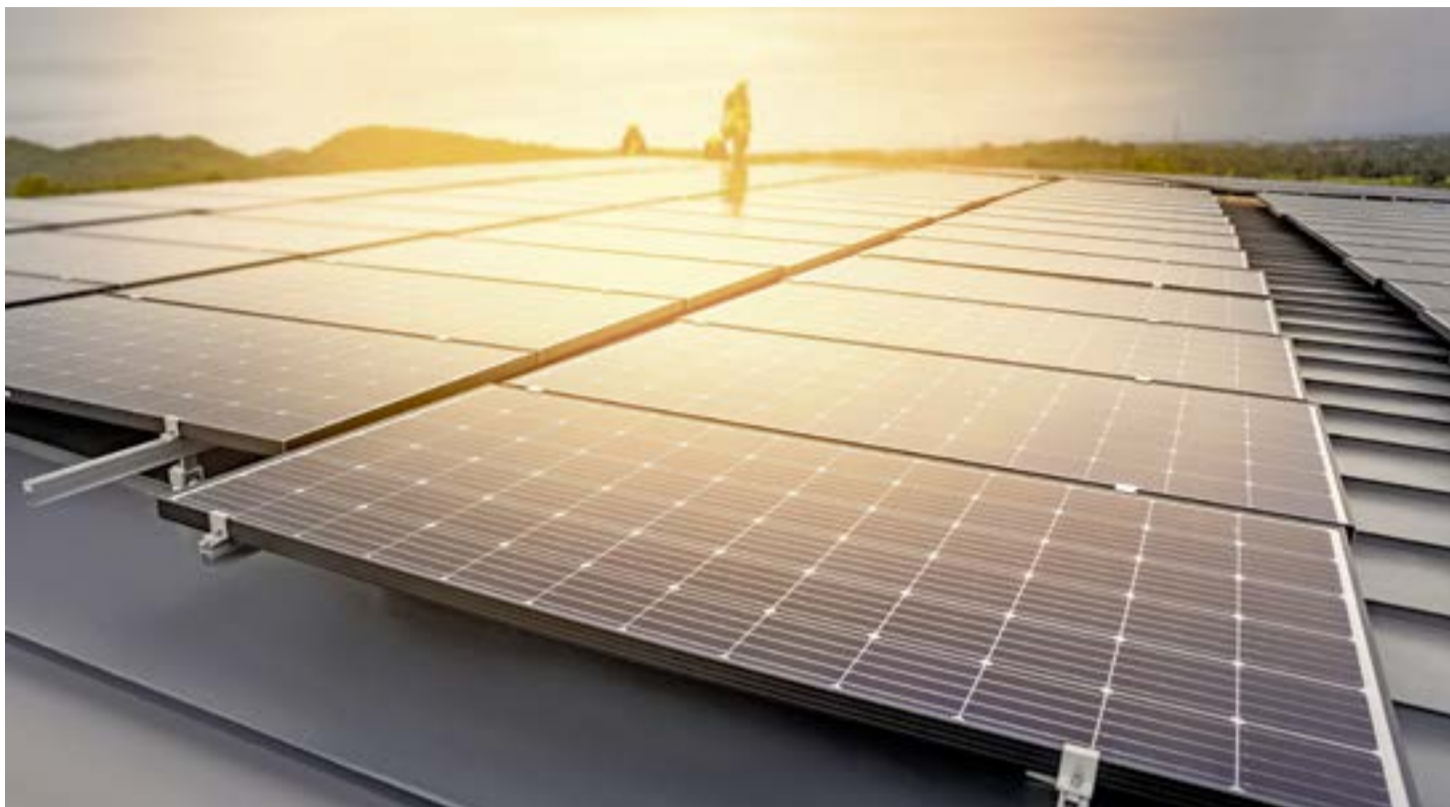
Couplé à une pompe à chaleur, le photovoltaïque permet une importante réduction des émissions de CO 2 .
